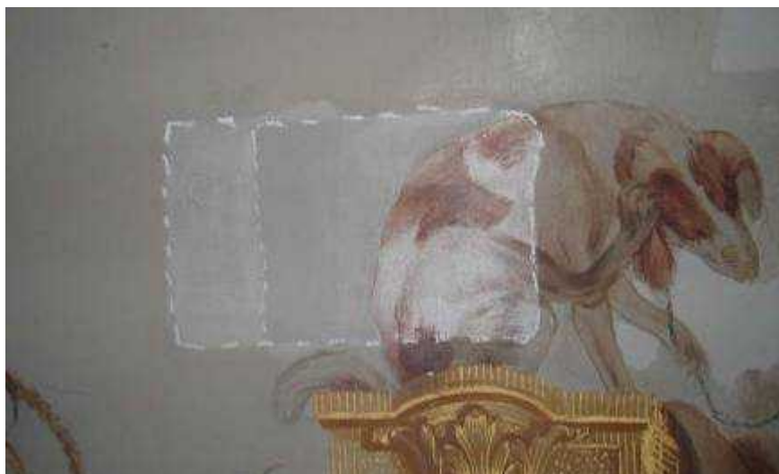
Sur le plafond, les sondages mettent en évidence deux rechapis gris superposés dus à des restaurations successives. A droite, certains rebouchages d'enduit ont éclairci par décoloration.
