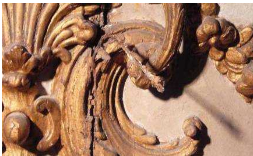
Sur les boiseries, des fentes dues au jeu du bois avaient fait l'objet de rebouchages anciens par de la filasse.
