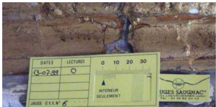
D'importantes fissures au niveau de la corniche en plâtre ont fait l'objet de mesures destinées à en évaluer l'ampleur et l'instabilité.
