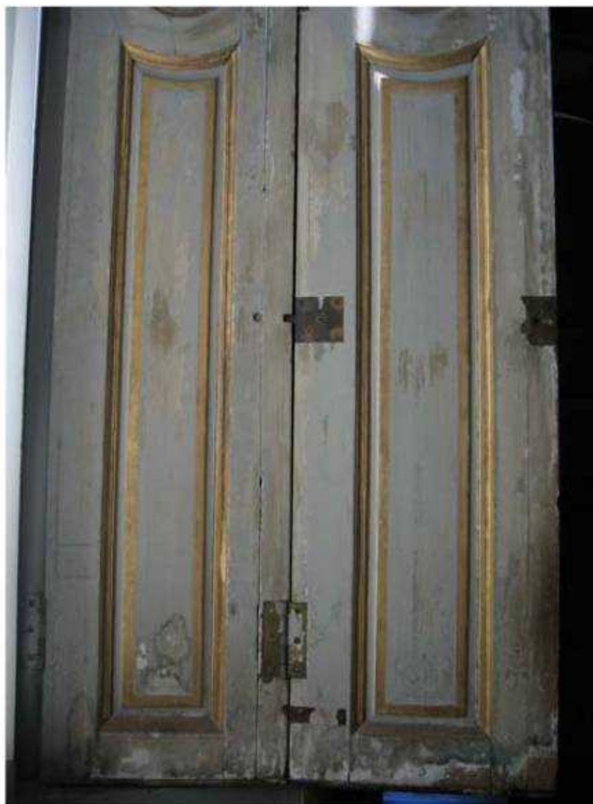
Sur les parties fréquemment repeintes, volets et portes, la succession des badigeons et les reprises ponctuelles s'étaient altérées sous l'effet de l'humidité.
